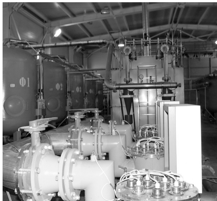
• На станции водоочистки.
